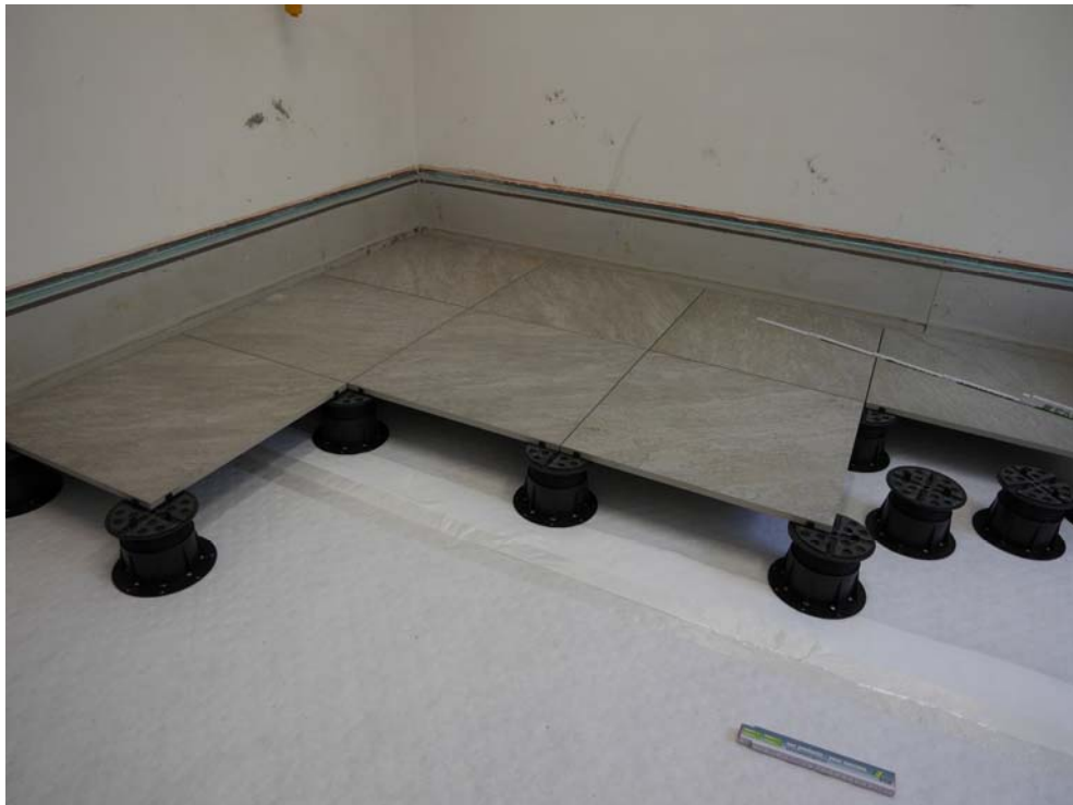
Abbildung B.3. Keramikfliesen auf Stelzlager und Regupol® sound and drain 22.
