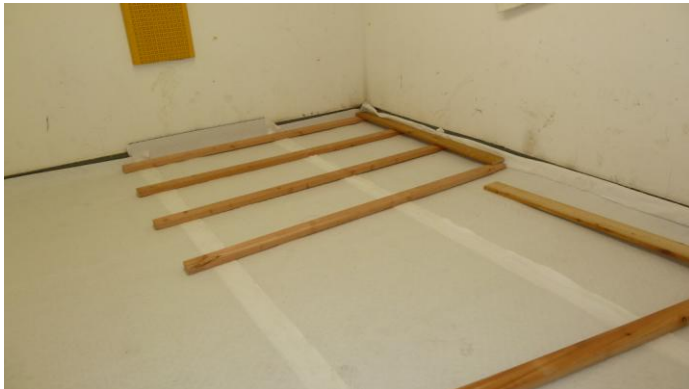
Regupol sound and drain, Dicke 15 mm, ausgelegt auf Bitumenschweißbahn, Vorbereitung der Lattung
